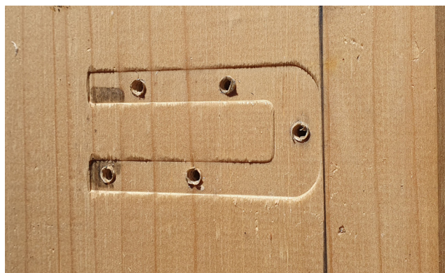
Image 2 Enfoncements importants dus à un serrage excessif
