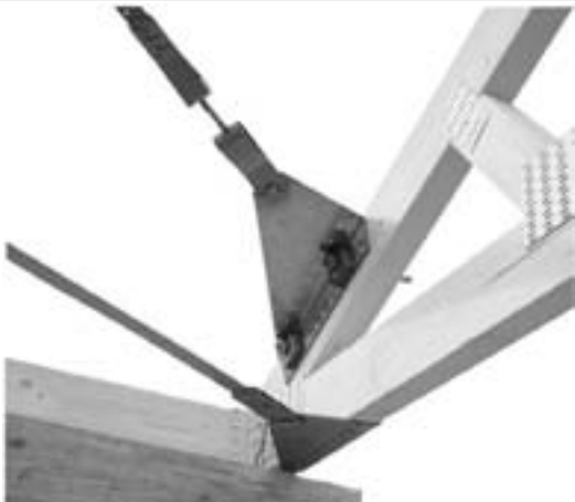
Detail am Traufpunkt: Bandanschluss G25 mit Bolzen M12 seitlich am Sparren verschraubt. Bandanschluss F25 auf der Unterseite des Sparrens befestigt.
